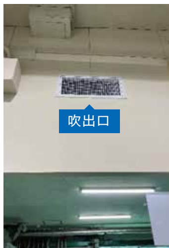
ダクトは、天井裏を通り、作業エリアに向かって吹き出す。
