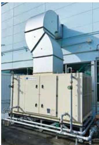
工場の横に設置し、ダクトで建屋内に給気する。
